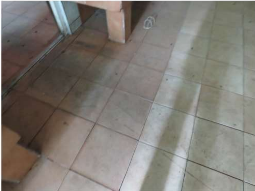
Фото 30. Трещины в керамической плитке напольного покрытия.
