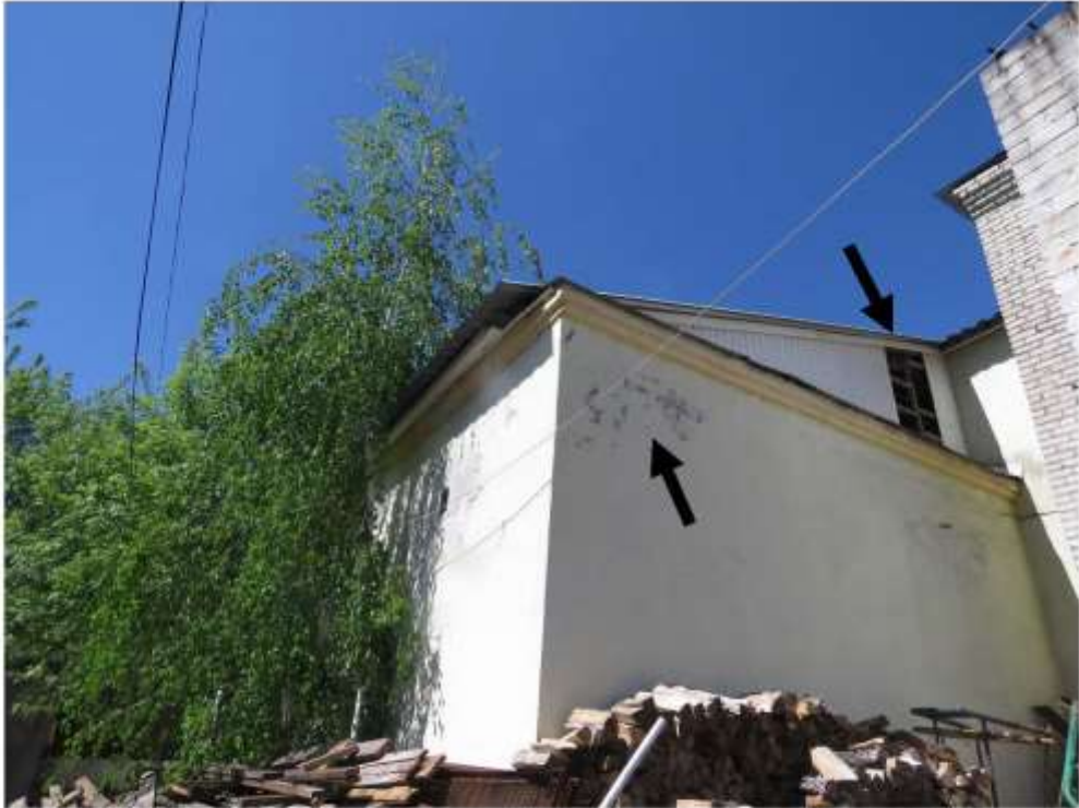
Фото 3. Общий вид одноэтажной части здания. Повреждение (шелушение, отслоение) отделочного слоя наружных стен. Разрушение обшивки крыши.
