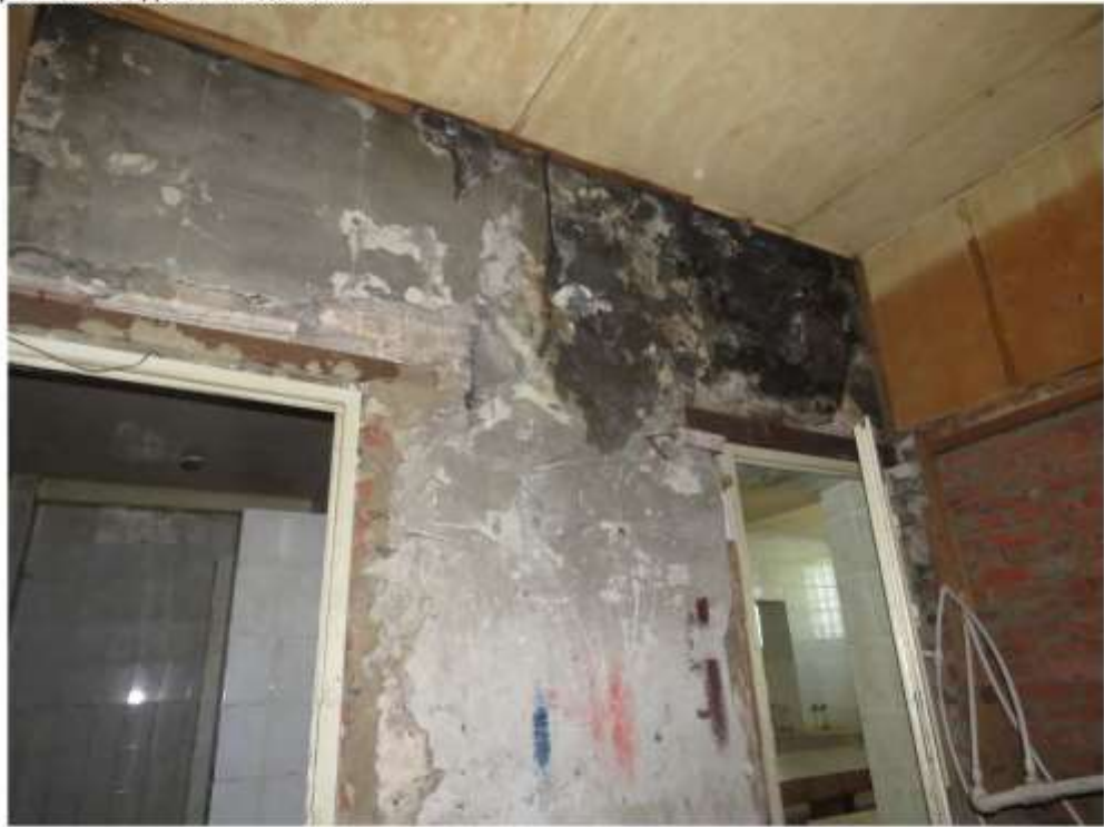
Фото 12. Следы поражения перегородок пожаром. Коррозия металлических перемычек перегородок.
