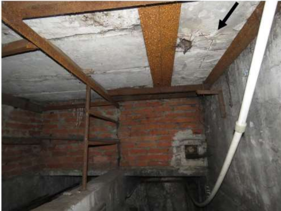
Фото 13. Коррозия металлических балок перекрытия. Оголение и коррозия арматурных стержней перекрытия.
