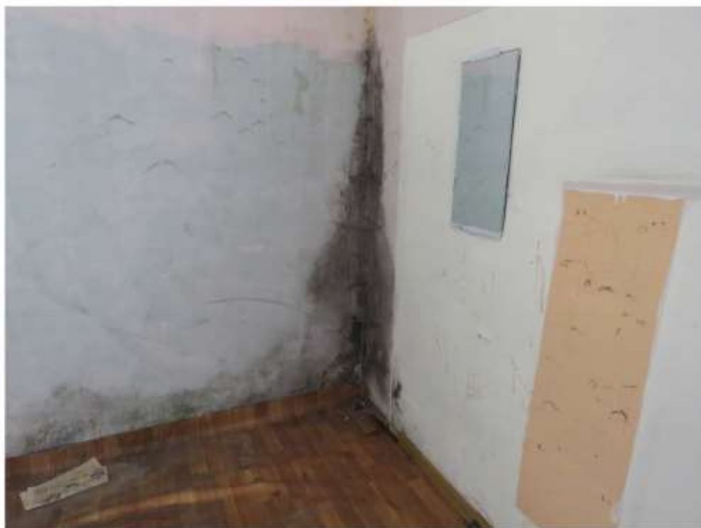
Фото 10. Следы появления низших форм растений (грибков, мхов). Повреждение (шелушение, отслоение) внутреннего отделочного слоя.
