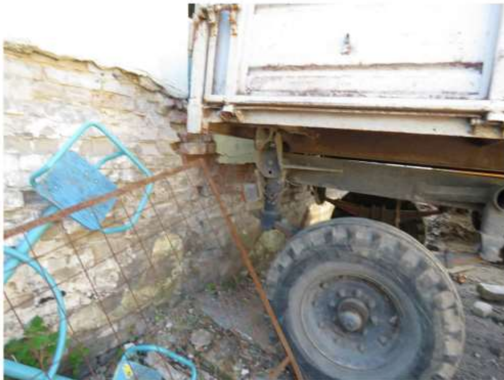
Фото 23. Повреждение (шелушение, отслоение) отделки цоколя. Разрушение отмостки.
