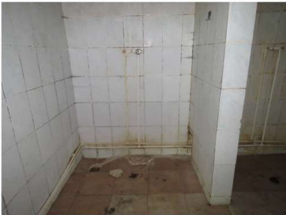
Фото 33. Расстройство запорной арматуры систем ХВС и ГВС. Следы скопления воды вокруг сливных трапов.
