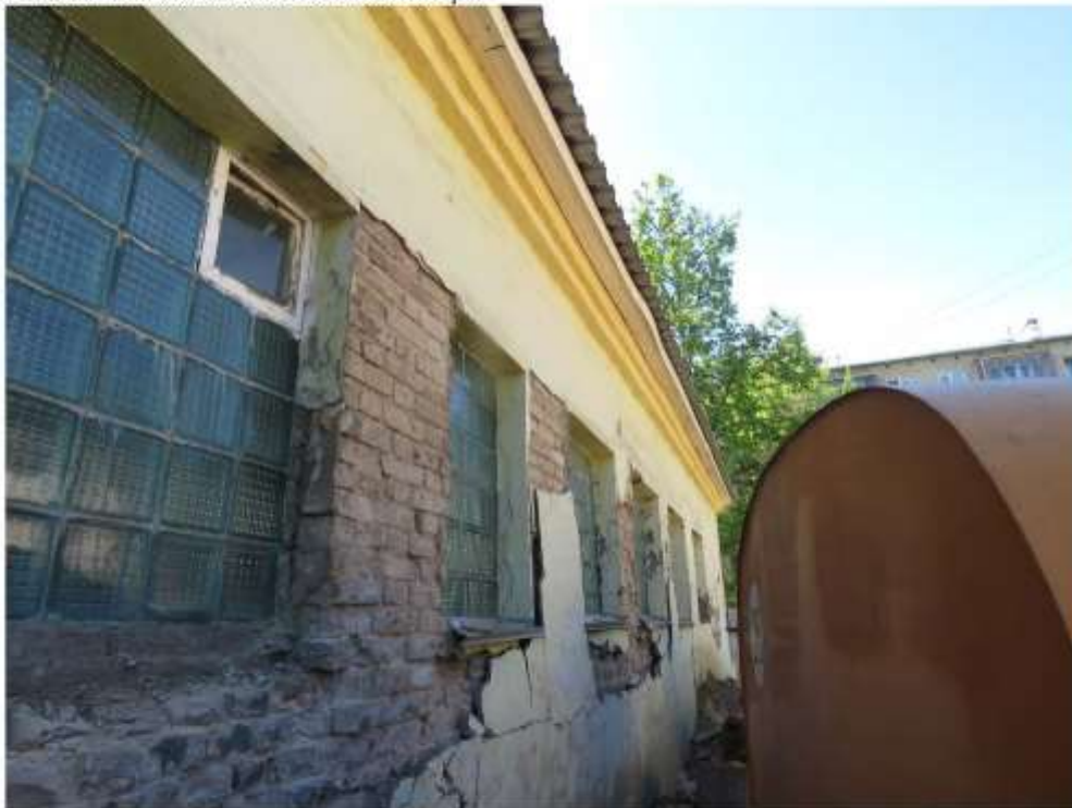
Фото 6. Повреждение (шелушение, отслоение) отделочного слоя наружных стен.
