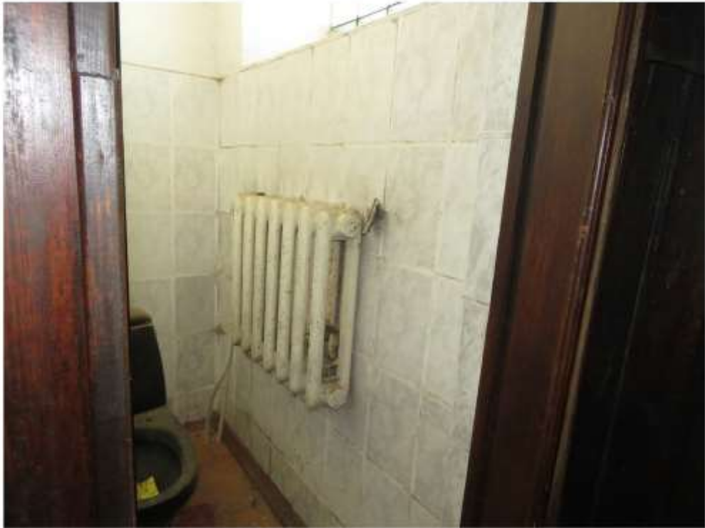
Фото 38. Коррозия отопительных приборов.
