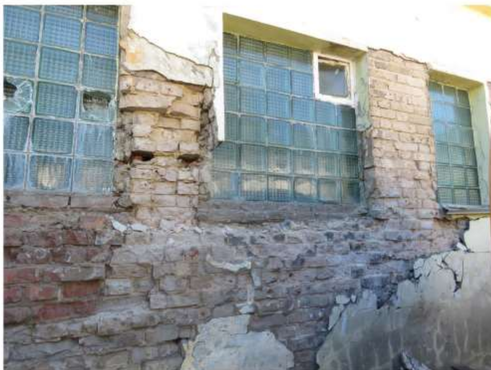
Фото 9. Разрушение кирпичной кладки наружных стен на глубину до 120 мм.
