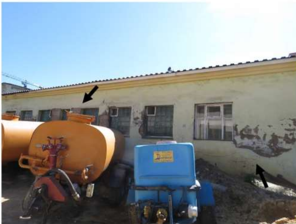
Фото 2. Общий вид одноэтажной части здания. Повреждение (шелушение, отслоение) отделочного слоя наружных стен.
