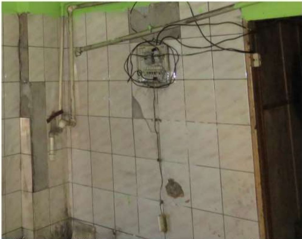
Фото 39. Неисправности ВРУ. Наличие временных прокладок электрокабелей.
