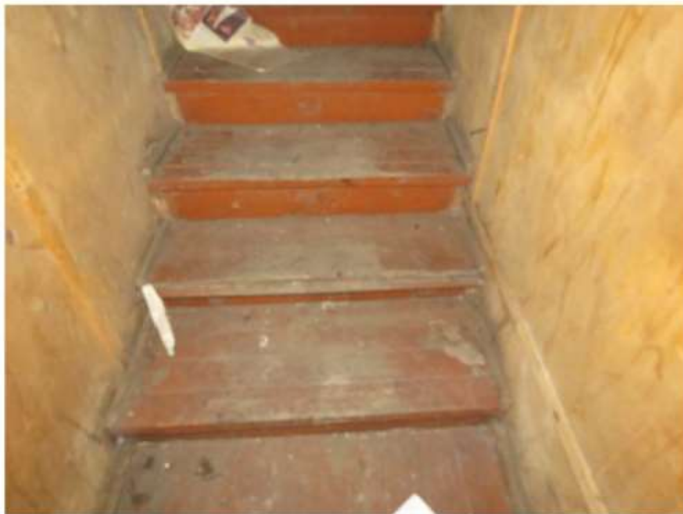
Фото 24. Истирание ступеней лестницы.
