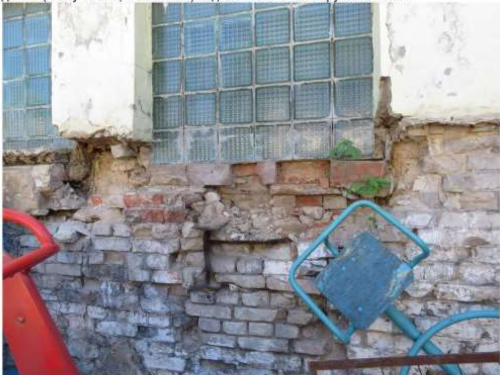
Фото 8. Разрушение кирпичной кладки наружных стен на глубину до 250 мм.
