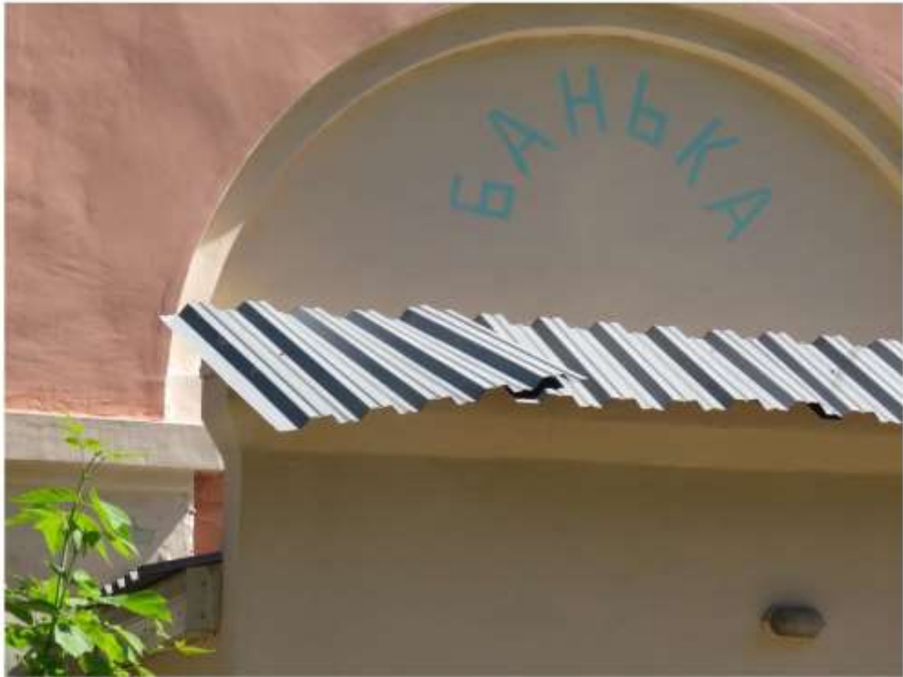
Фото 21. Искривление и нарушение крепления кровельных листов.
