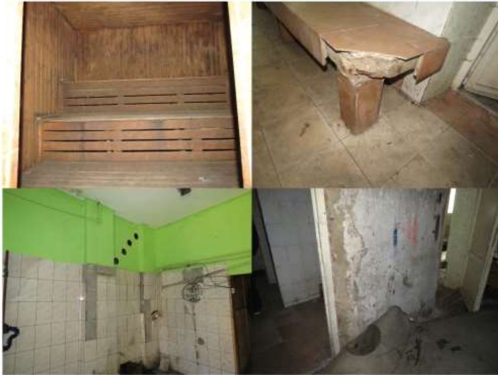
Фото 25-28. Повреждение внутренней отделки помещений.
