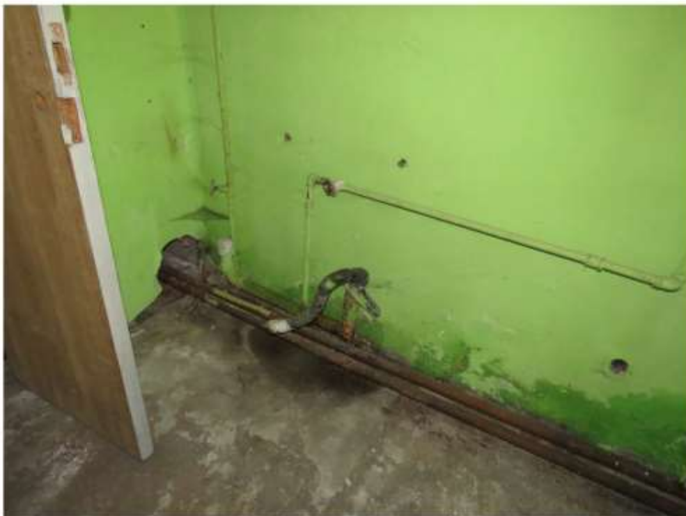
Фото 35. Коррозия трубопроводов систем ХВС, ГВС и канализации. Течи в местах присоединения приборов системы канализации.
