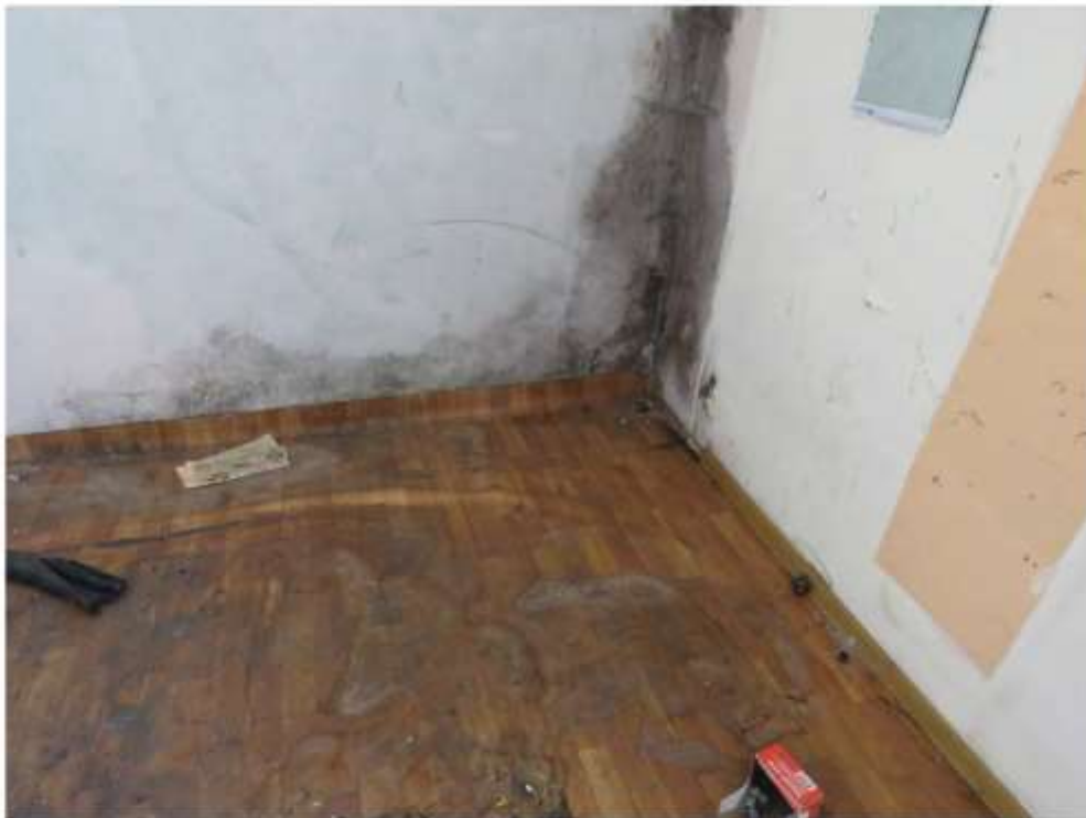
Фото 29. Истирание и вздутие напольного покрытия.
