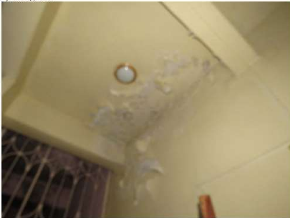
Фото 16. Следы протечек кровли. Повреждение (шелушение, отслоение) отделочного слоя перекрытия.
