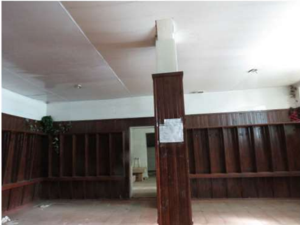
Фото 15. Прогибы подшивки перекрытия из пластиковых панелей. Общий вид внутренних помещений здания.
