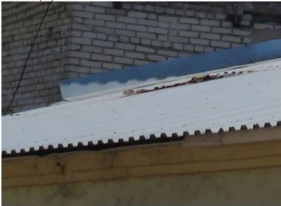
Фото 20. Искривление и нарушение крепления кровельных листов.
