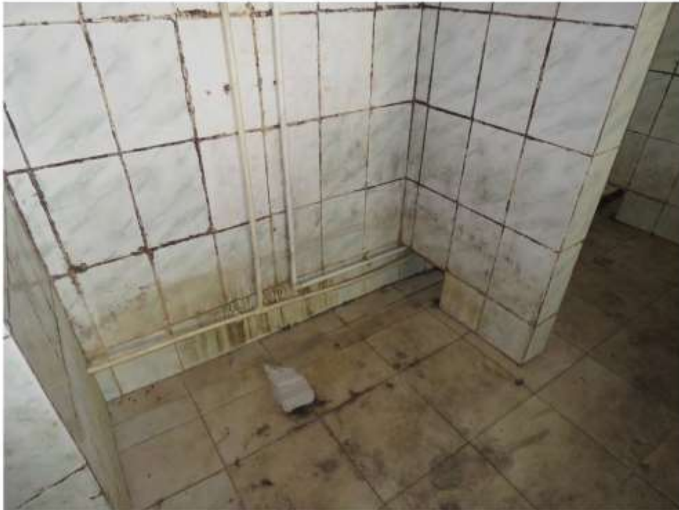
Фото 32. Деформации трубопроводов систем ХВС и ГВС.
