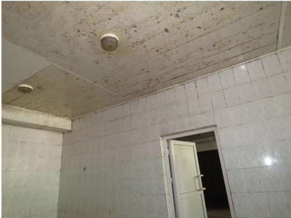
Фото 19. Следы появления низших форм растений (грибков, мхов) на поверхности отделочного слоя перекрытия.
