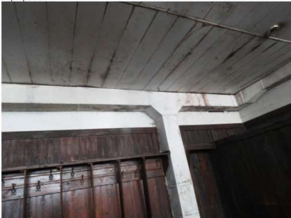
Фото 18. Следы появления низших форм растений (грибков, мхов) на поверхности отделочного слоя перекрытия.
