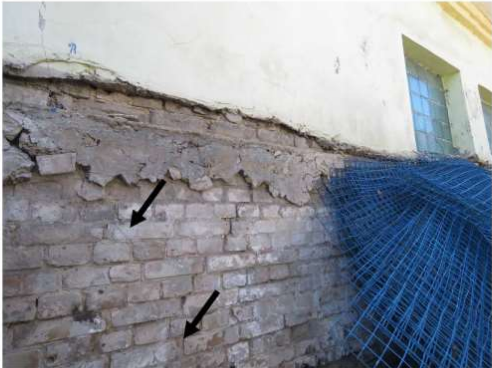
Фото 7. Трещины в кирпичной кладке наружных стен, шириной раскрытия до 0,3 мм. Повреждение (шелушение, отслоение) отделочного слоя наружных стен.
