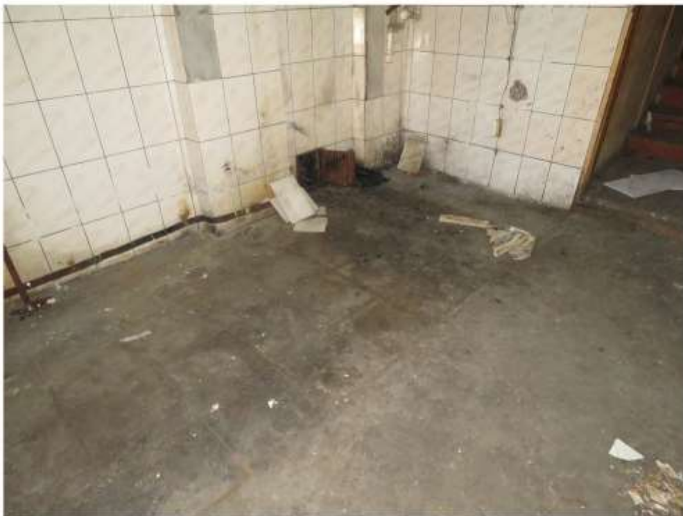
Фото 31. Участки отсутствия напольного покрытия.
