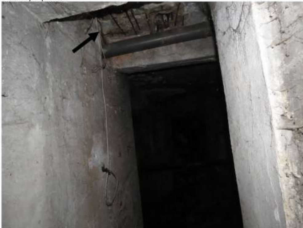
Фото 14. Оголение и коррозия арматурных стержней перекрытия.
