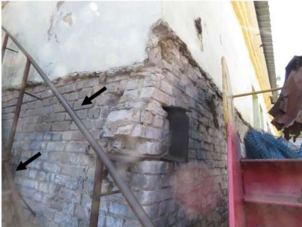
Фото 5. Повреждение (шелушение, отслоение) отделочного слоя наружных стен. Коррозия металлических элементов лестницы.
