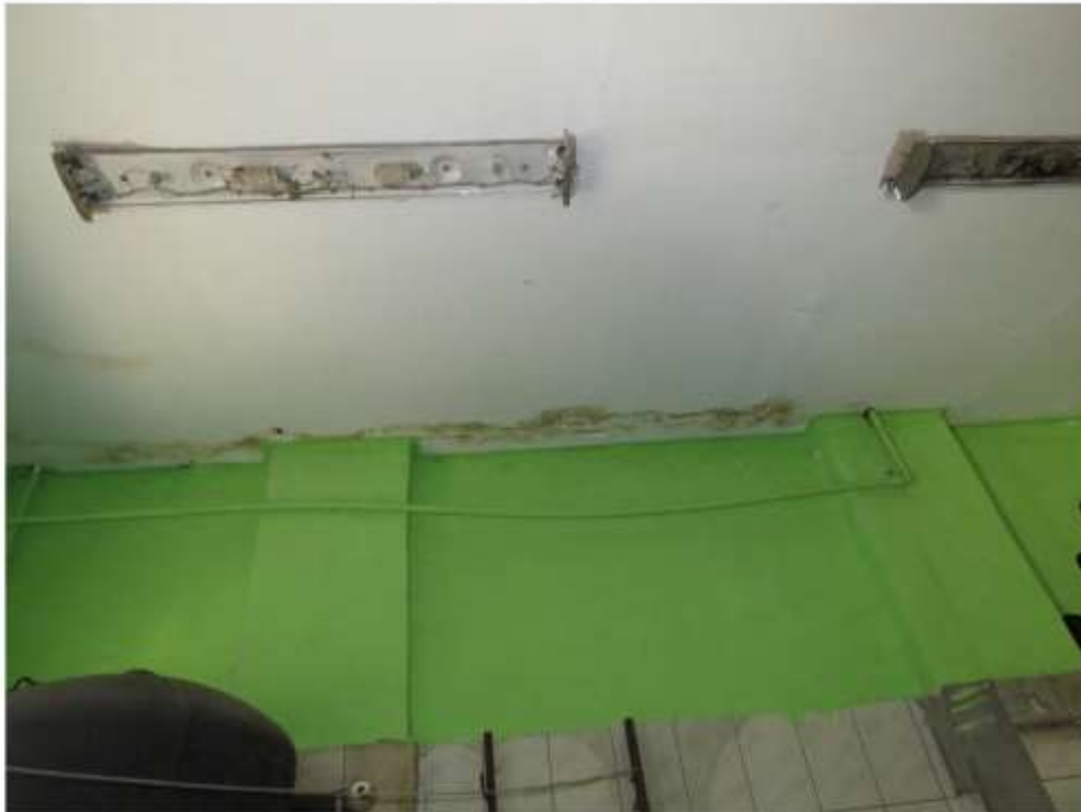
Фото 40. Отсутствие части приборов и крышек к ним (электропитание).
