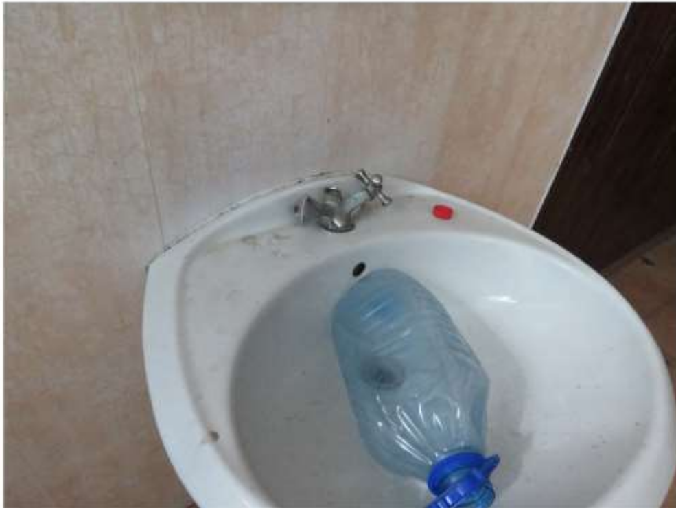
Фото 34. Повреждение смесителя и эмалированного покрытия раковины.
