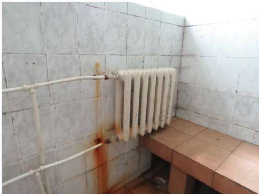
Фото 36. Течи в отопительных приборах и местах их врезки. Деформации трубопроводов системы отопления.
