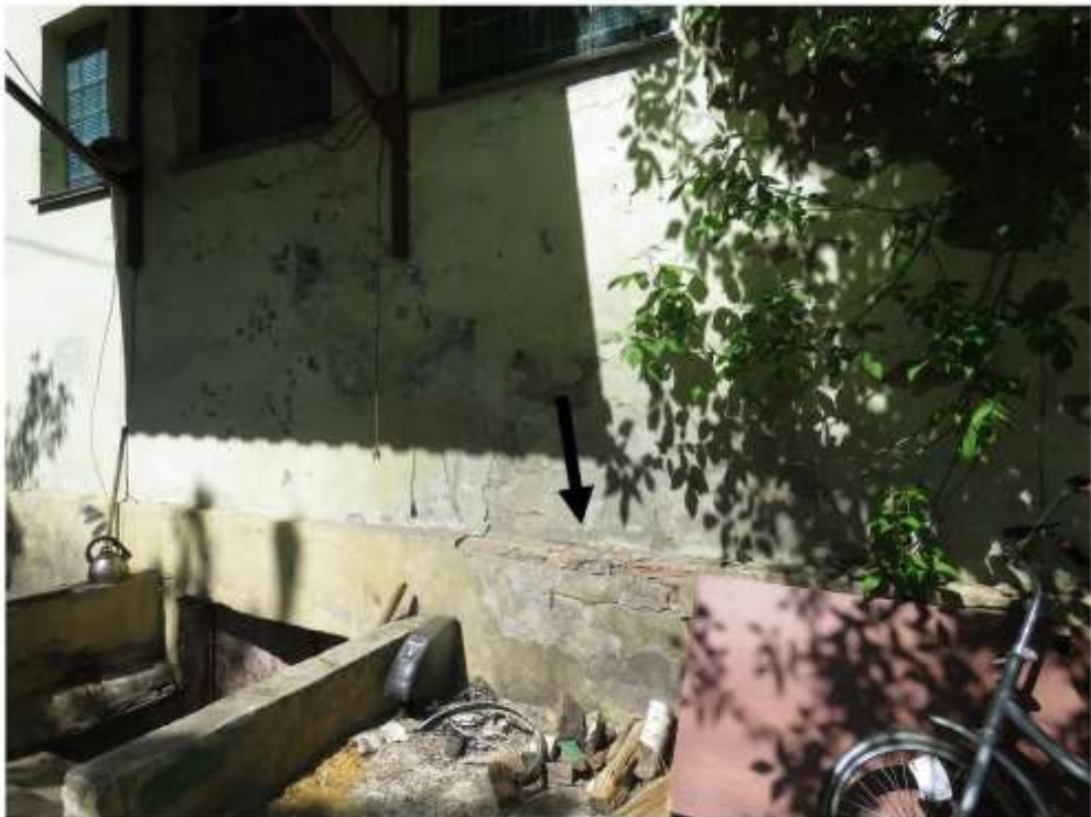
Фото 22. Повреждение (шелушение, отслоение) отделки цоколя.
