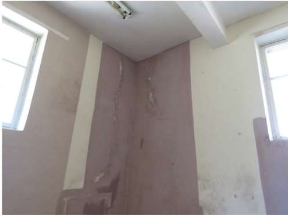
Фото 11. Следы намокания поверхности стен. Повреждение (шелушение, отслоение) внутреннего отделочного слоя.
